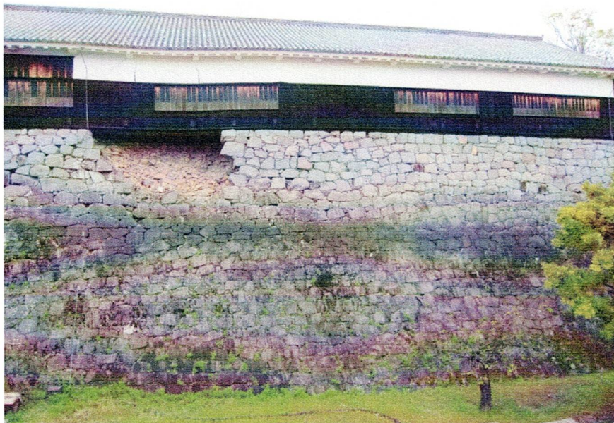
数寄屋丸二階広間の崩落の後
